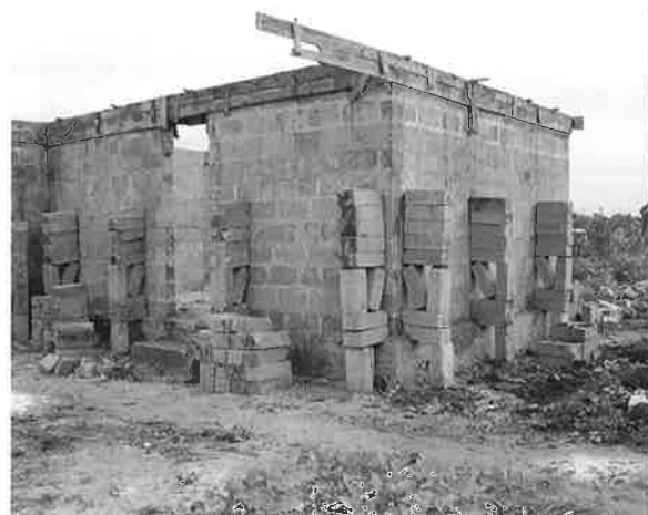
Kontorsdelen. Längst upp på väggen gjuts en "ringbeam", en armerad betongbalk som ska ge väggarna stadga. Som byggställning används cementblock som staplas till den höjd som behövs. Inte helt säkert och inte helt ofarligt.
