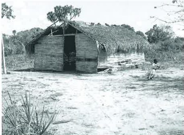
Den gamla kyrkan av bambuväggar och stråtak håller på att falla sönder. Termiterna har börjat äta på väggstolparna och på kyrkbänkarna.
